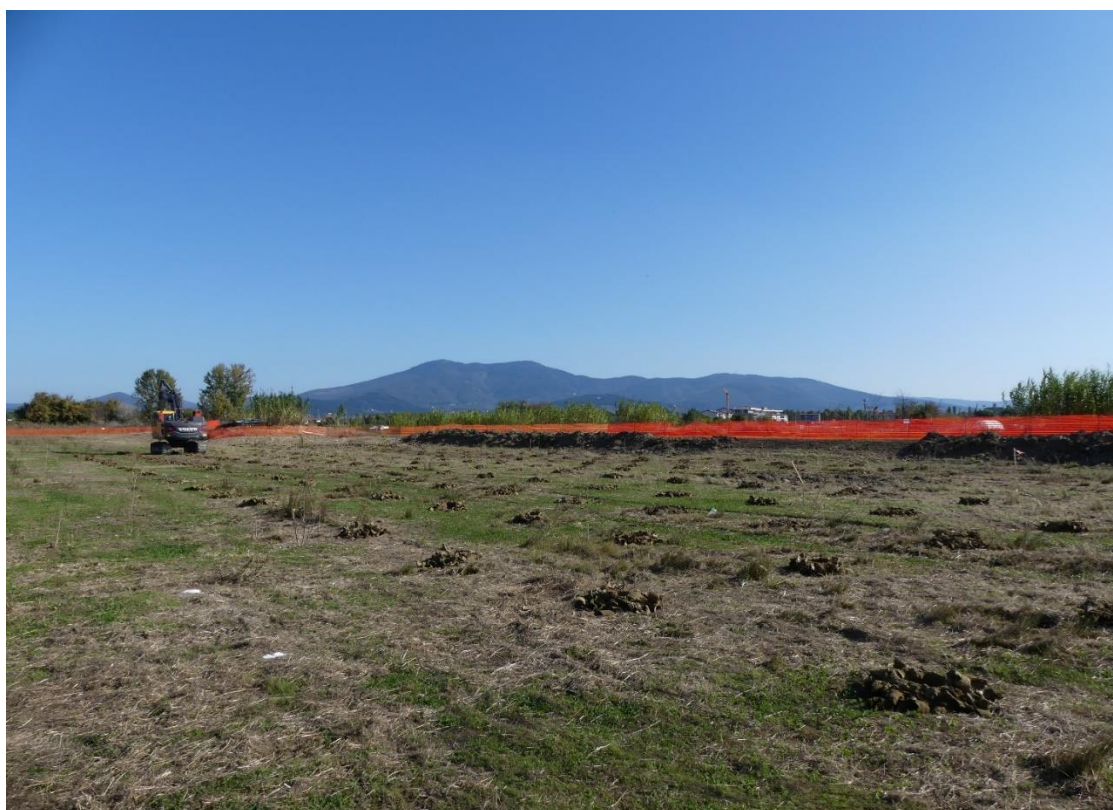
Figure 23 e 24 - Esempi di fori di trivellazione per la ricerca di ordigni bellici (B.O.B.) ove possono cadere migliaia di individui di tutte le specie di piccole dimensioni. Foto realizzate presso alcuni cantieri nella Piana Fiorentina (Foto C. Scoccianti – Anni 2013 e 2021)
